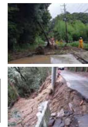
台風第13号による被害
