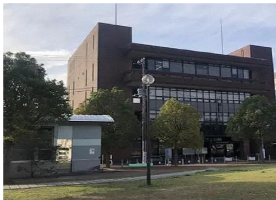
図一 13 公共施設の老朽化（五井会館）
