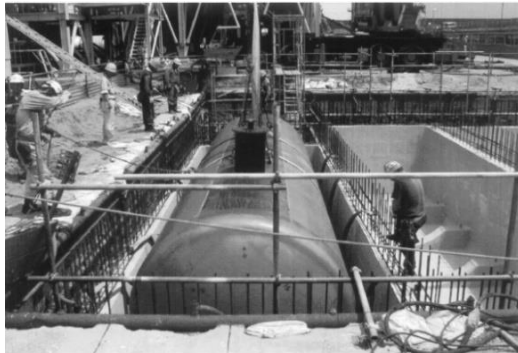
地下タンク貯蔵所 143 施設
