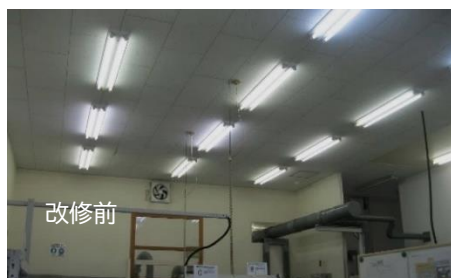
照明設備のLED化
