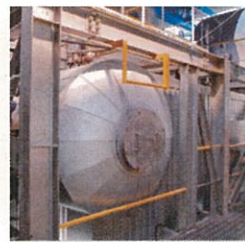
4 廃熱ボイラ Boiler 焼却によって発生した燃焼ガスの熱エネルギーを回収して蒸気を作ります。最大蒸発量は1基あたり12.3t/hです。
