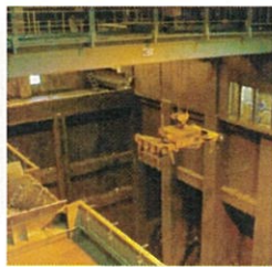
2 ごみピット・ごみクレーン Waste pit & Waste crane ごみを安定燃焼させるために、ごみクレーンによりごみを十分攪拌し、ごみの状態を均一にします。
