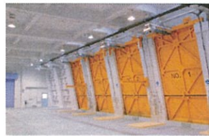
これは音声コードです 1 プラットホーム・投入扉 Platform & Dumping gate 投入口には投入扉が設置されており、ごみピットからの粉じんや臭気の拡散を防止します。
