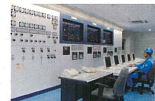
これは音声コードです 中央制御室 Central Control Room 施設の運転と制御を集中的に行います。また、運転状態の監視やデータ処理もここで行われます。
