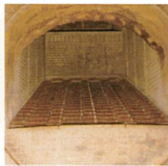
3 焼却炉 (ストーカー炉) 内部 Incinerator 焼却炉に投入されたごみは、乾燥・焼却・後燃焼ストーカーの工程を経て完全燃焼します。炉壁の裏側に空気を循環させて溶融物の付着を抑制し、燃焼の安定化をはかっています。
