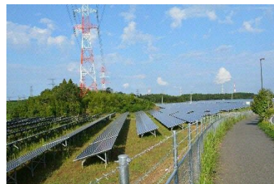
市内に設置された太陽光パネル
